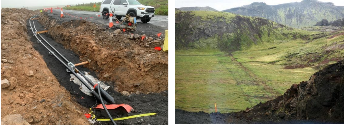
Mynd 6.18 Til vinstri er dæmi um umfang á lagningu 132 kV strengs, eitt sett við Korpulínu í Reykjavík sem var sett í streng 2020. Til hægri má sjá frágang eftir lagningu 132 kV Nesjavallastrengs 2, við Hengilssvæði, sumarið eftir framkvæmdir.
